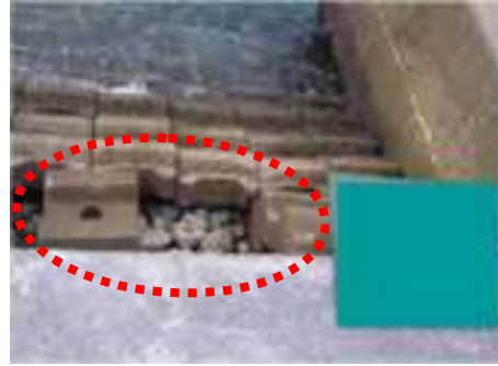
写真 5-02：劣化度判定『b』
