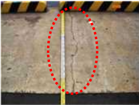
写真 4-01：劣化度判定『b』
