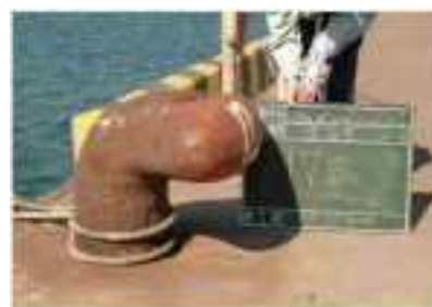
写真 3-7.1 係船柱の変状の事例
