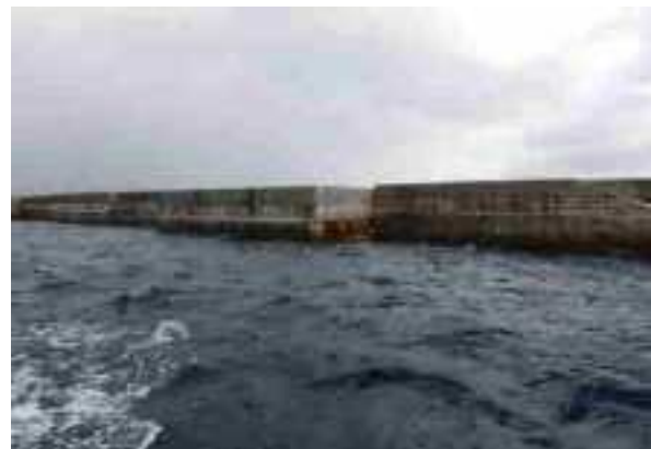
ケーソンの港内側への滑動
