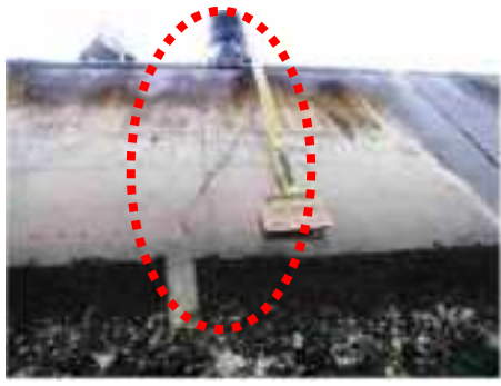
写真 4-04：劣化度判定『b』
