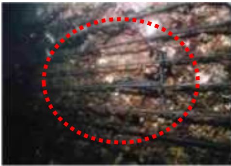
写真 3-01：劣化度判定『a』
