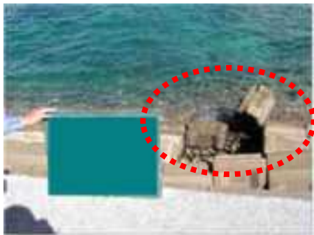
写真 5-03：劣化度判定『c』
