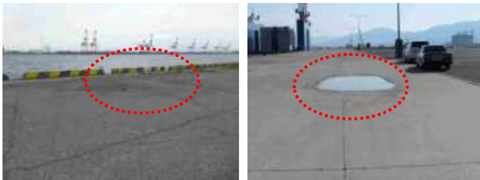
写真 3-2.1 エプロンの沈下、陥没の事例（左 As 舗装、右 Co 舗装）
