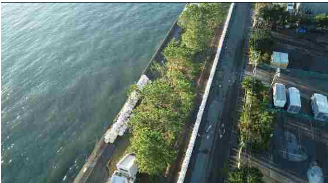
図－7 金沢区福浦地区 パラペットの土嚢の飛散が少なく、背後の土嚢は飛散していない箇所
