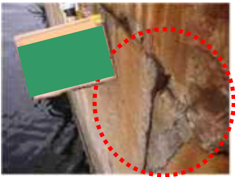
写真 4-03：劣化度判定『b』
