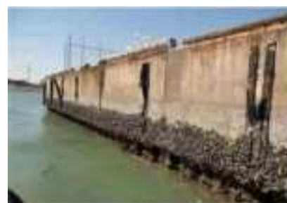
写真 3-7.2 防衝設備の変状の事例
