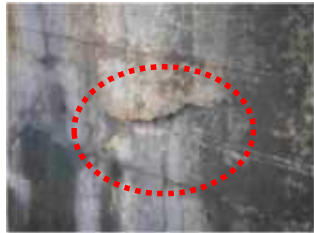
写真 4-02：劣化度判定『b』
