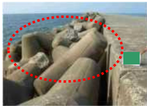
写真 4-02：劣化度判定『b』
