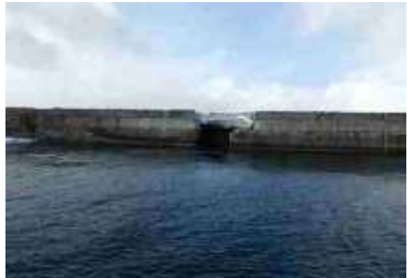
ケーソン・上部工の損壊
