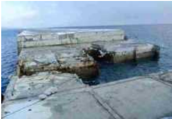
ケーソン・上部工の損壊
