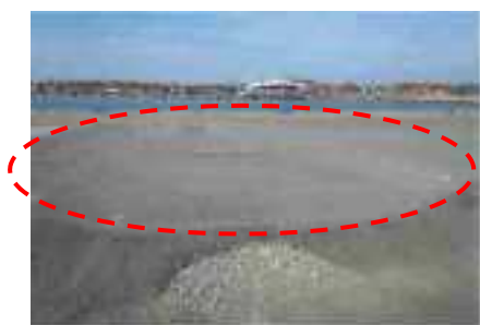
写真 3-6.1 エプロンの沈下事例
