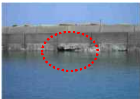
(コンクリートブロックの欠損)
